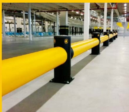
iFlex Single Traffic Barrier vymezuje trasy manipulační techniky v nově vybudované balárně.
