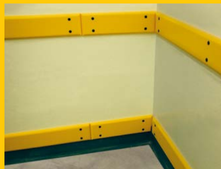
Okopové desky na stěnách pro zamezení nárazů a vzniku oděrek na povrchu stěn.
