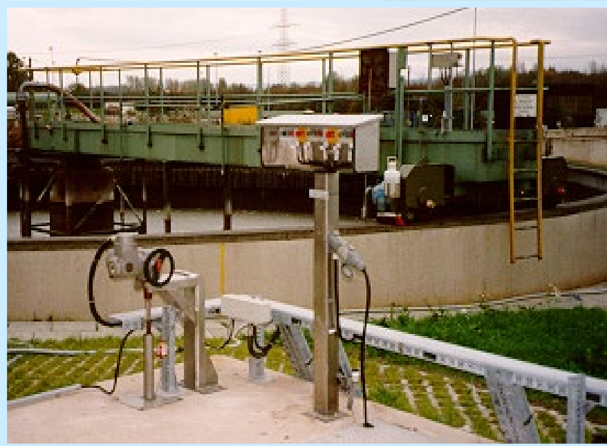
Připojení míchadel DS3, 50A, 400V 6+PE+3 pom. kontakty
