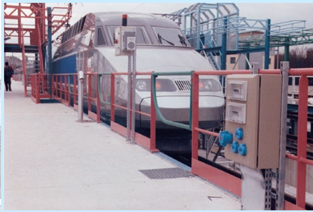
El. připojení v opravně TGV-vlaků (Francie) DS3 na rozváděči
