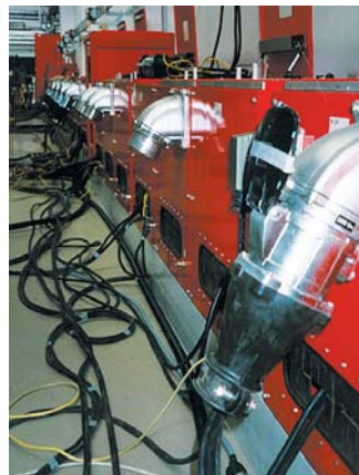
Obr. 2 Zkušebna motorů (DS2 – 400 V, 250 A, 3F + PE + 2 pomocné kontakty)
